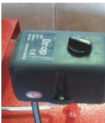
شکل ۱۸۸- جعبه کلید قطع و وصل جریان برق
