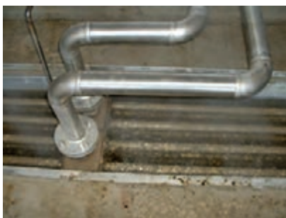
شکل ۶۱- کویل‌های حرارتی برای گرم کردن هوای کوره
