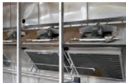
شکل ۴۰- انتقال حرارت کویل‌ها به وسیله فن‌ها
