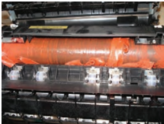
شکل ۳-۳۶- غلتک پرس معیوب
